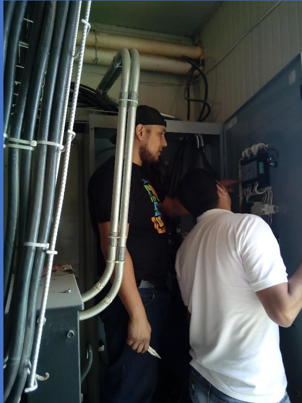
Mantenimiento a Plante Eléctrica de Emergencia
