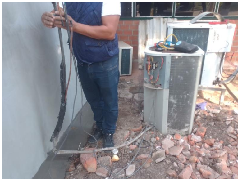
Ilustración 31 Mantenimiento de aires acondicionados-2
