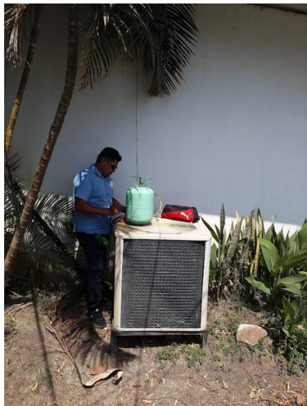
Ilustración 30 Mantenimiento de aires acondicionados
